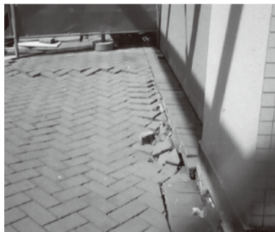
1号棟:陥没して浮き上がったタイル
