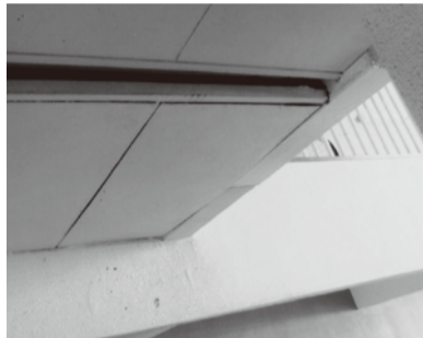
6号棟南北の渡り廊下:はがれた天井
